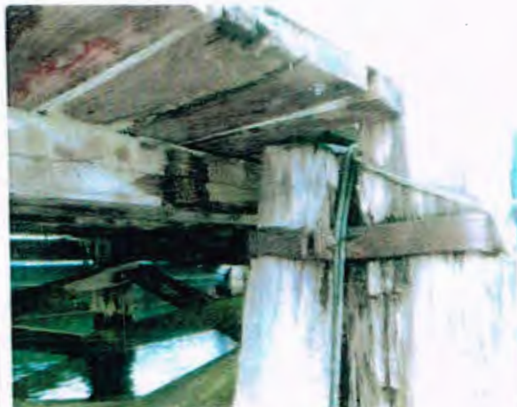
Bild 8: Die Dalben stehen ohne tragende Verbindung neben den Brücken
