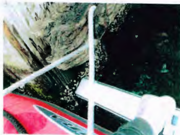
Bild 11: Bohrwiderstandsmessung an Dalbe Süd 3
