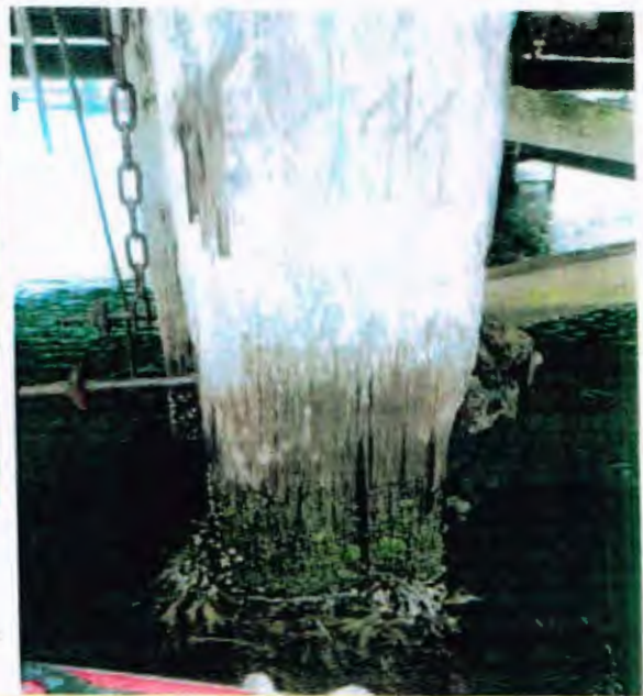
Bild 18: Dalbe 7 (11 zählt vom Ufer). Die Oberfläche läßt eine Schädigung vermuten. Die
