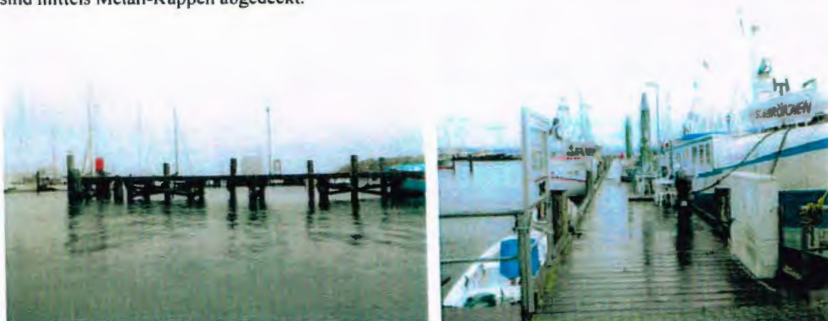
Bilder 5 und 6: Übersicht über die Tanker-Brücke. Aufgrund der dort liegenden Schiffe waren die Pfähle nur eingeschränkt zugänglich.
