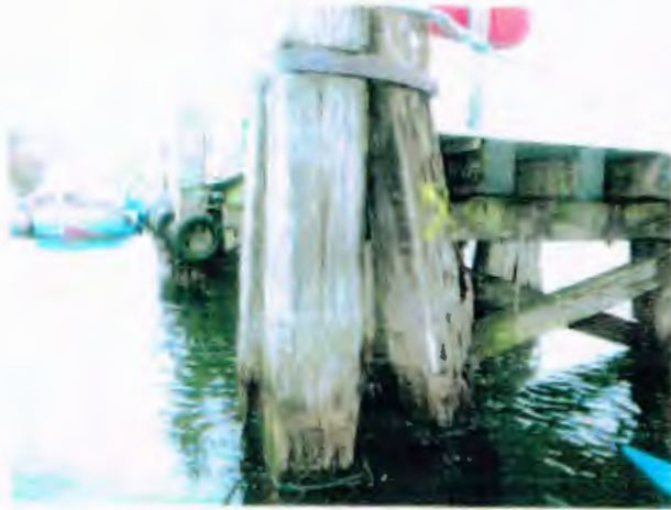
Bild 37: Dalbe D1 Nord. Das Holz ist gesund, siehe Grafik 12. Die Strebe rechts ist dagegen sichtbar geschädigt aber noch funktionsfähig.
