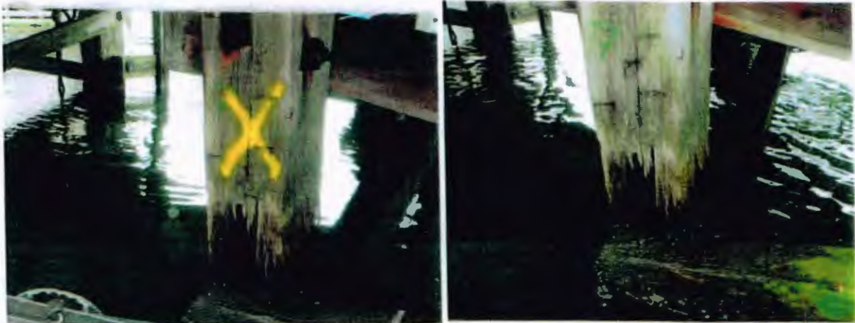
Bilder 22 und 23: Pfahl 18 Nord. Die Schädigung ist offen sichtbar. Betroffen ist der Kontaktbereich zu den Streben.
