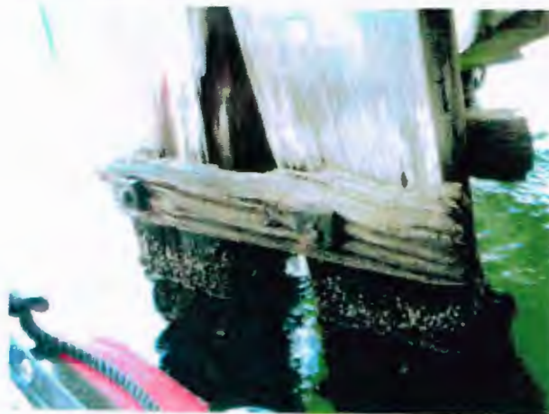
Bild 10: Dalbe Süd 3: Oberflächliche Schäden. Der Eichen-Riegel ist sehr stark erodiert
