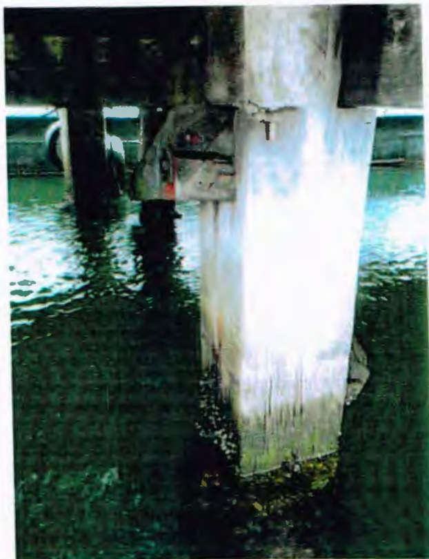
Bild 19: Pfahl 15 Süd. Sichtbar ist eine geringe Schädigung der Oberfläche.
