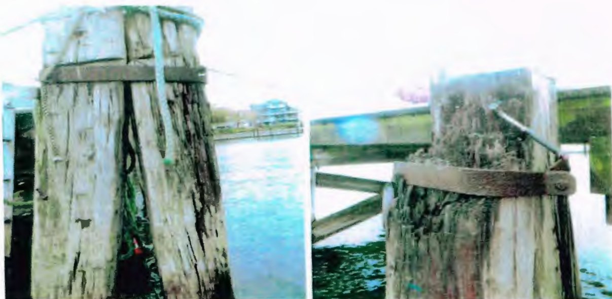
Bild 39: Dalbe 1 Süd: Gesundes Holz, vergl. Grafik 12. Die Strebe zeigt deutliche Schäden an der Oberfläche bis ca. 10cm Tiefe
