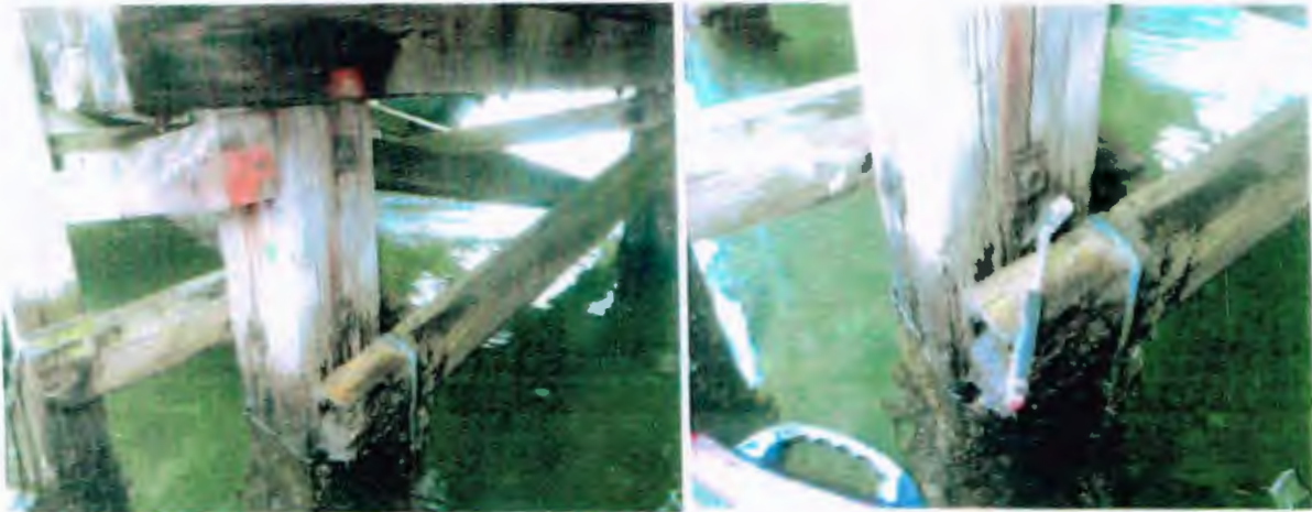
Bilder 20 und 21: Pfahl 17 Süd. Eine Schädigung ist im Kontaktbereich zur Strebe sichtbar (Hammer) Die Bohrwiderstandsmessung zeigt keine Schäden
