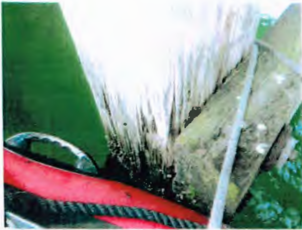
Bild 17: Pfahl Süd 10. Oberflächlich ist kaum eine Schädigung erkennbar.
